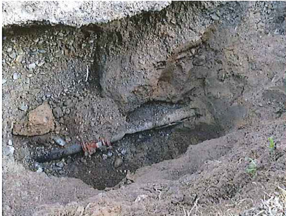
neben 2016 reparierter Stelle
